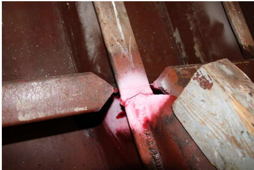
Рисунок 4.1.1 – Тріщина втоми в місці з'єднання шпангоута і днищевих конструкцій
