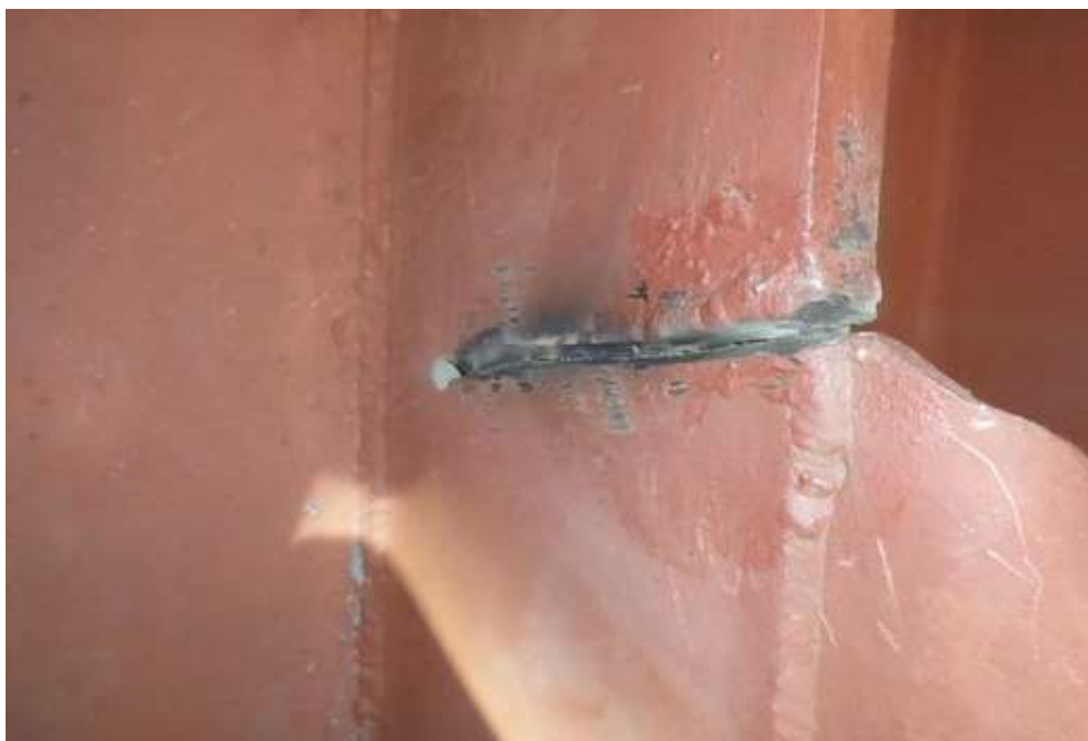
Рис. 1.3. Тріщина втоми у вузлі
