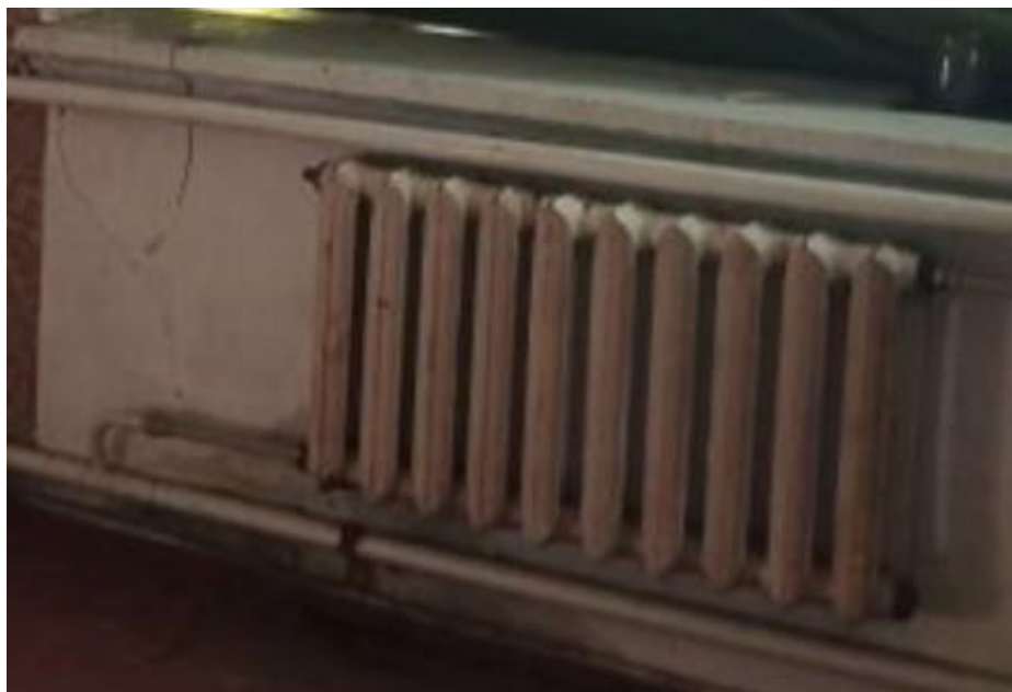
Рисунок 1.5. Опалювальні прилади секційні чавунні радіатори
