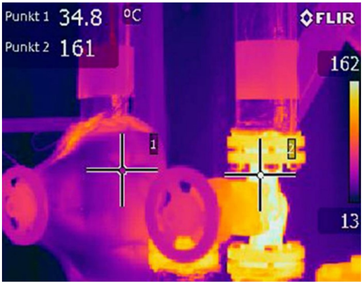
Рисунок 3.4 Термограми засувки на паропроводах
