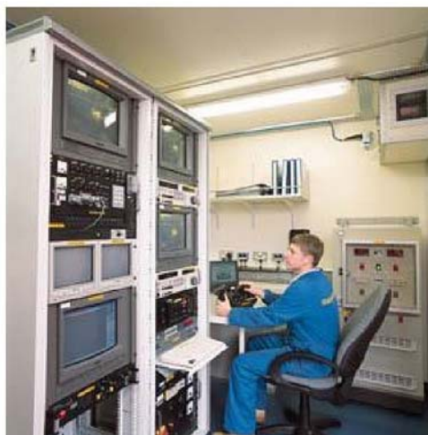
Рисунок 1.2 – Вигляд робочого місця оператора СППА в середині контейнера
