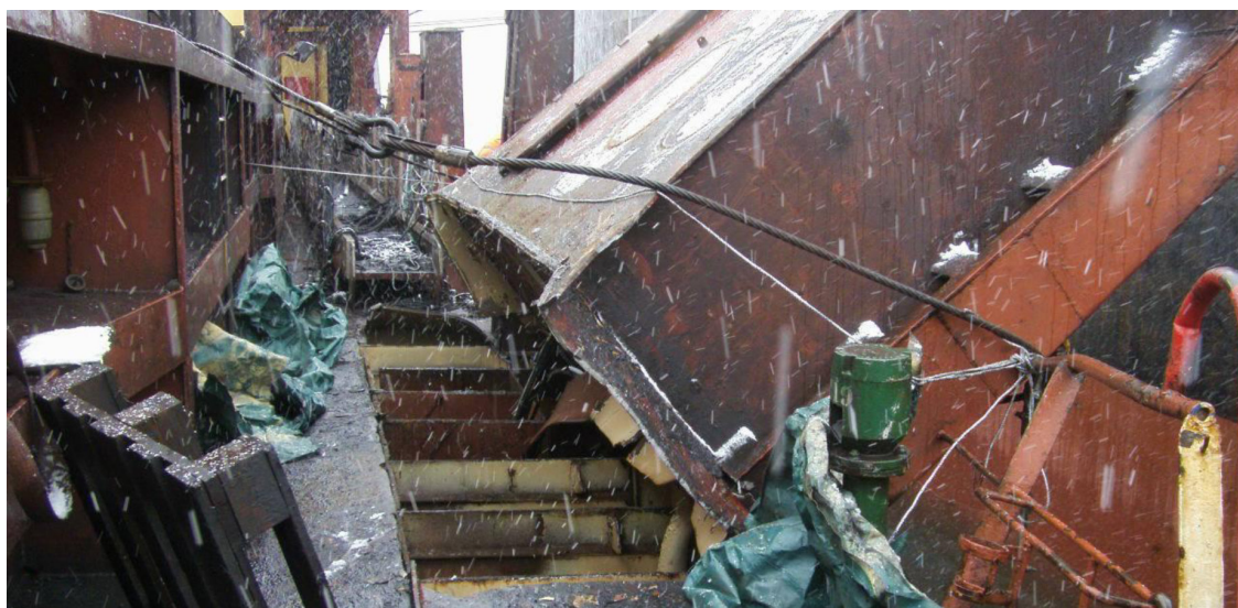
Рис. 3. Зруйнована частина стріли. Видимі деформації листових елементів та порушення зварних швів
