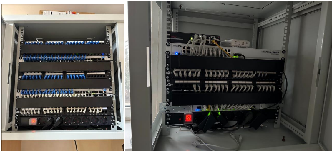
Рисунок 3.3 – Телекомунікаційна шафа після оновлення
