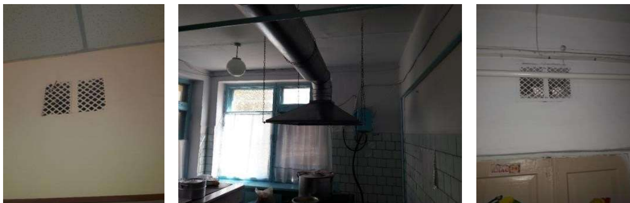
Рисунок 2.8 Зовнішній вигляд системи вентиляції
