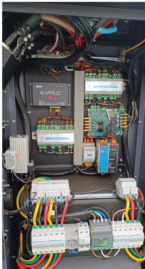
Рисунок 5.3– Автозарядна станція всередині
