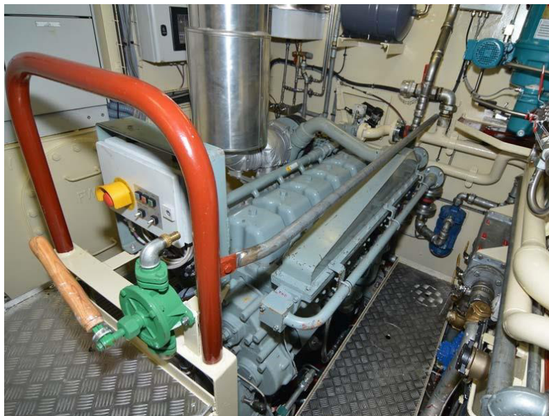
Рисунок 2.4 – Загальний вигляд дизель-генератора Mitsubishi Marine Diesel Engine Model S6A3a [16-19]
