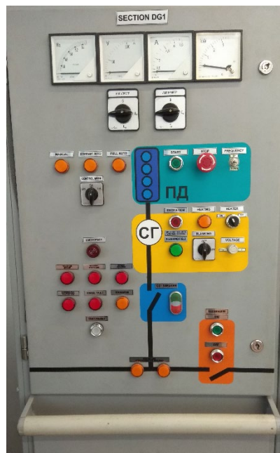
Рис.2. Зовнішній вигляд генераторної секції DG1
