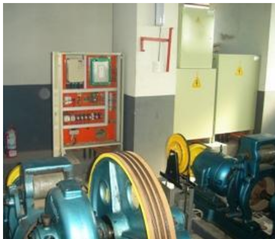
Рисунок 2.5 – Приміщення з автоматикою ліфту
