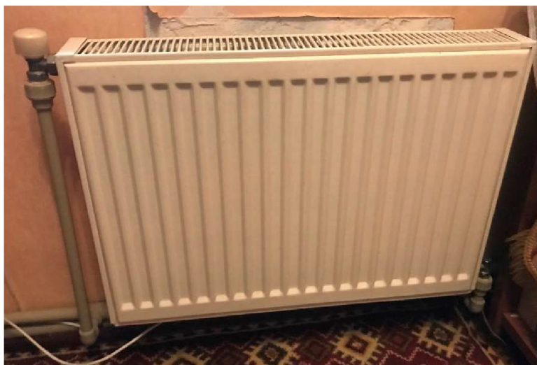
Рис. 3.3. Металічні секційні радіатори в будівлі
