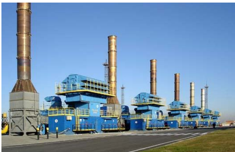
Рис. 3.12. Компресорна станція з газоперекачувальними агрегатами компанії ПАТ "Сумське НВО ім. М.В. Фрунзе"
