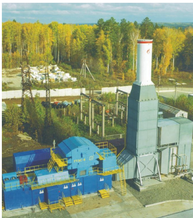
Рис. 3.4. Зовнішній вигляд електростанції ГТЭС-4000
