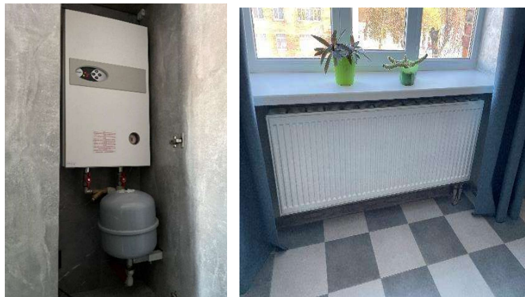
Рис. 2.5. Електричний котел та радіатор системи опалення [17]
