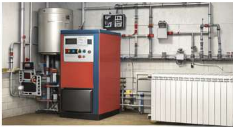
Рис. 5.2. Модернізація теплового вузла і системи опалення [17]
