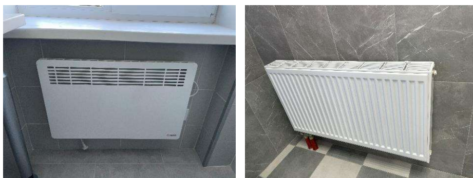
Рис. 2.6. Опалювальні прилади у приміщеннях гуртожитку [17]
