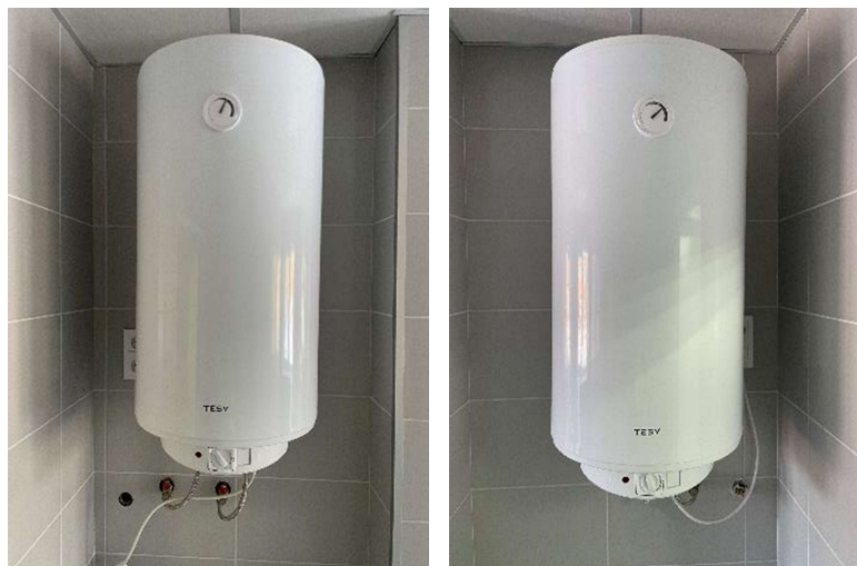
Рис. 2.9. Електричні бойлери системи гарячого водопостачання [17]
