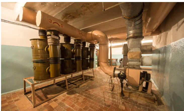
Рис. 6.4. Кімната проточної вентиляції з розміщеними в ній фільтрами-поглиначами
