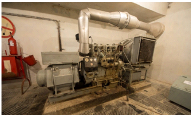
Рис. 6.6. Дизель-генератор, призначений для забезпечення захисної споруди електроенергією у випадку загального знеструмлення
