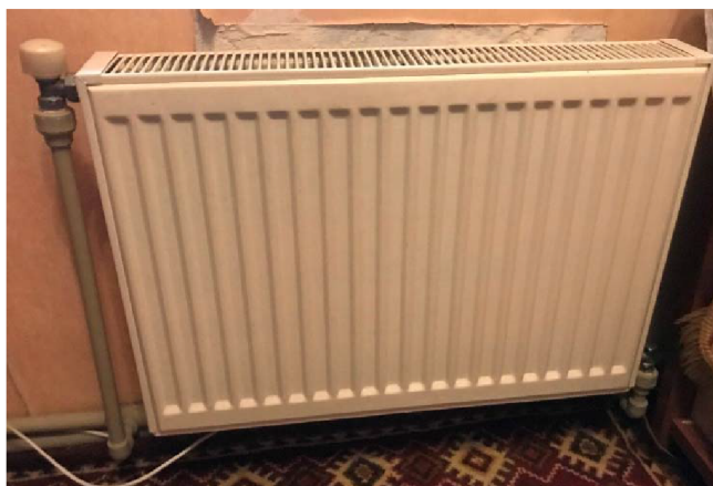
Рис. 3.4. Металічні секційні радіатори в будівлі.
