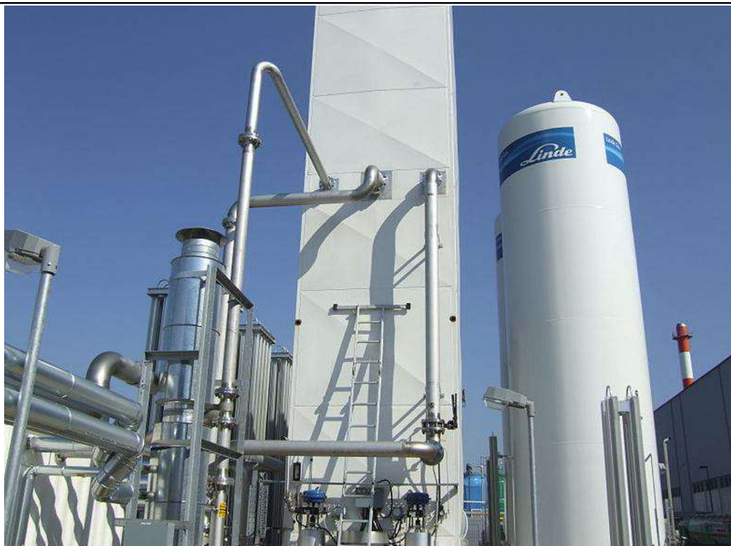
Рис. 2.6. Ректифікаційна колона установки розділення повітря
