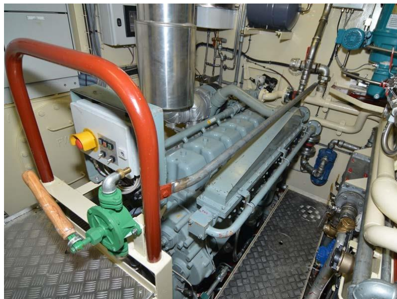
Рисунок 1.4 – Загальний вигляд дизель-генератора Mitsubishi Marine Diesel Engine Model S6A3a [1-3]
