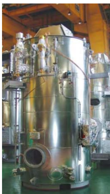
Рис 4.5 – Допоміжний котел KangRim PA-06 [21]
