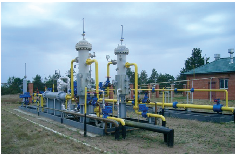
Рис. 4.12. Газорозподільна станція (Миколаївська область)
