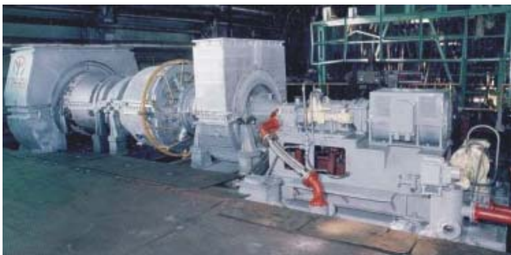
Рис. 22Д. Газотурбинный агрегат GTН-6У
