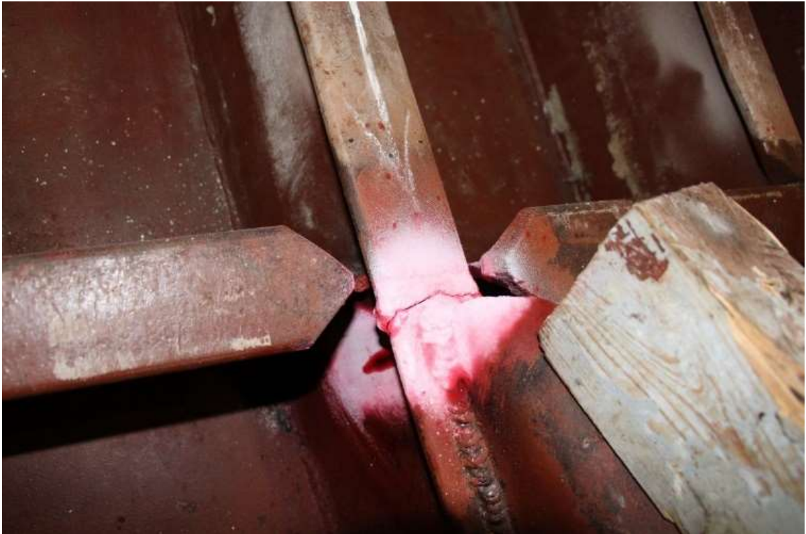
Рис. 1.4. Тріщина втоми у конструктивному вузлі
