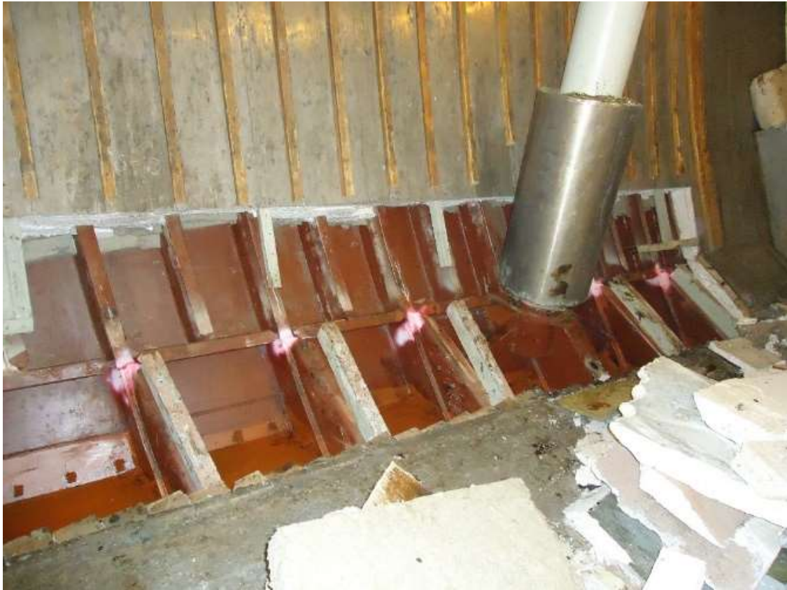
Рис. 1.3. Загальний вид досліджуваної конструкції із тріщинами втоми
