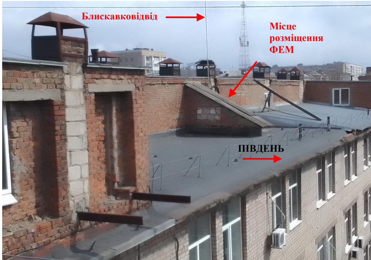
Рисунок 2.9 – Місце розміщення фотоелектричних модулів
