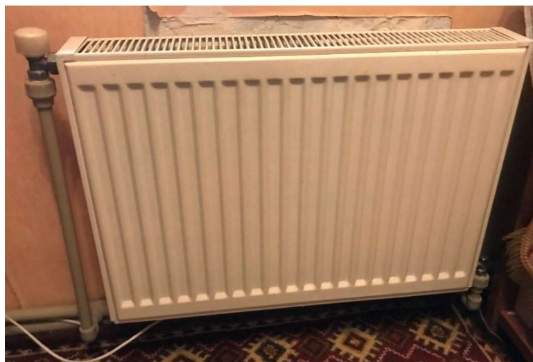
Рис. 3.3. Металічні секційні радіатори в будівлі
