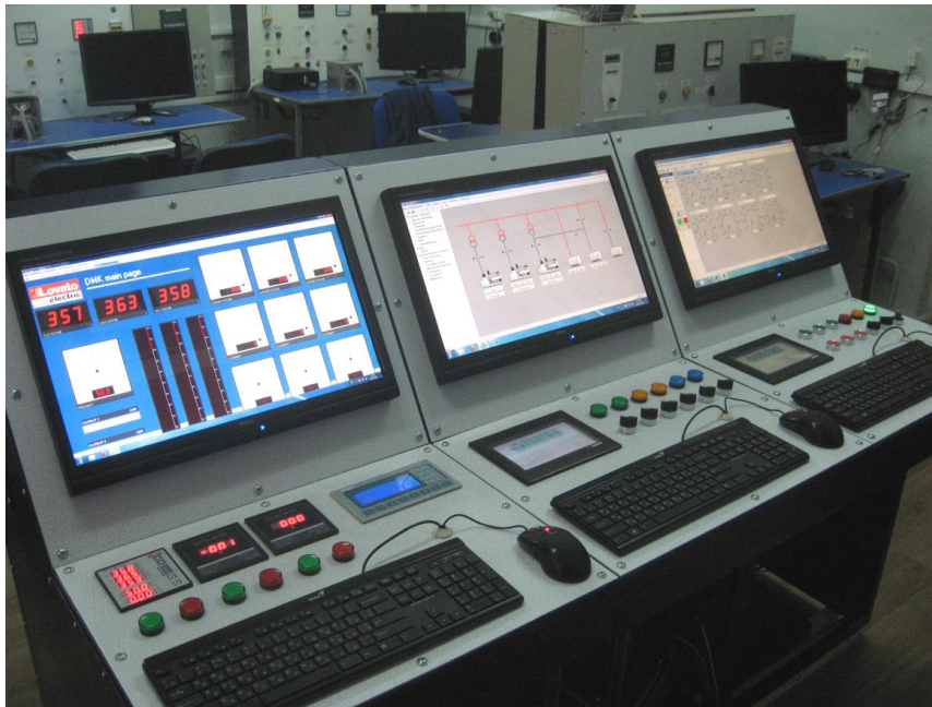
Рис. 4.16. Пульт управління судною електроенергетичною системою
