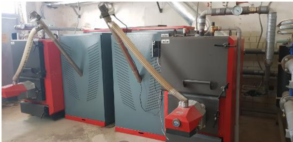
Рис. 3.1 – Розташування твердопаливних котлів Marten MIT-700P в котельні
