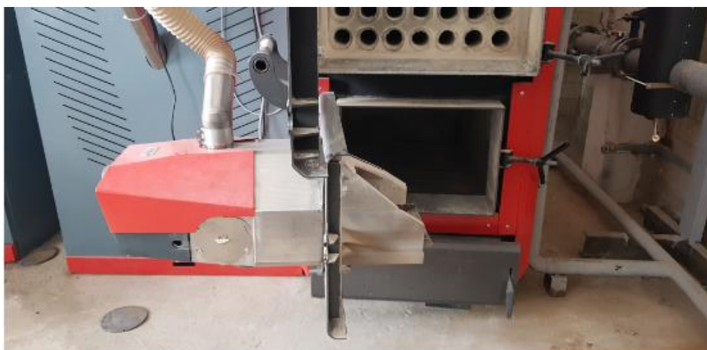
Рис. Б.1 – Встановлені пелетні котли Marten MIT-700P в котельні
