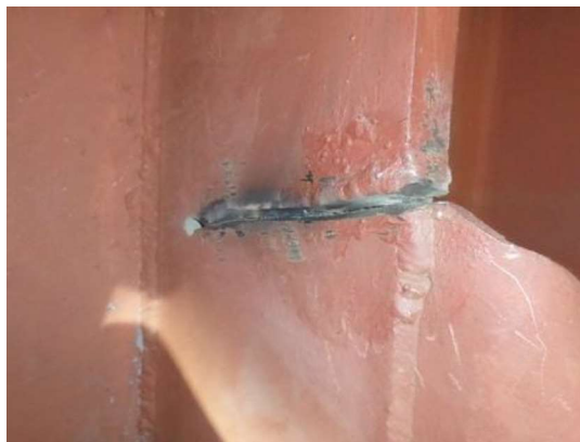
Рисунок 1 – Тріщина втомі в місці з'єднання основного шпангоуту із другим дном, підкріпленого кницею
