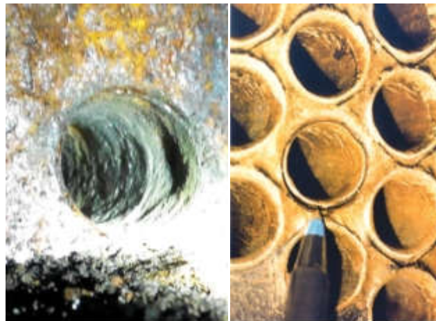
Рис. 2.1. Корозійні пошкодження труб теплообмінників: б – на кінцевих ділянках; в – щілинна корозія
