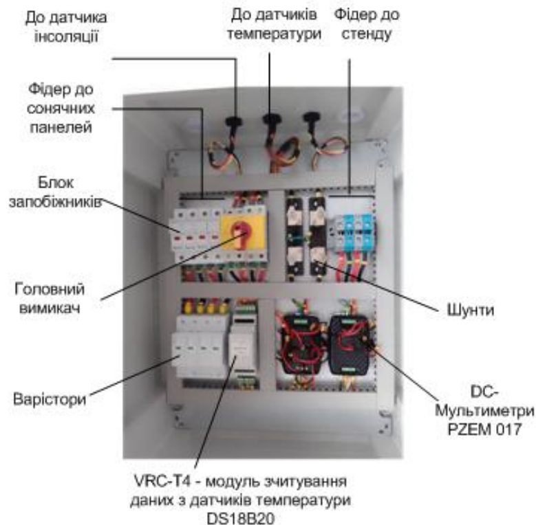
Рисунок 2.5 – Зовнішній вигляд щита підключення фотоелектричних модулів
