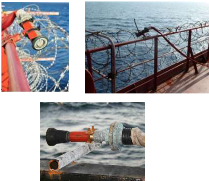
Рис. 4.4. Стационарно закріплений пожежний ствол
