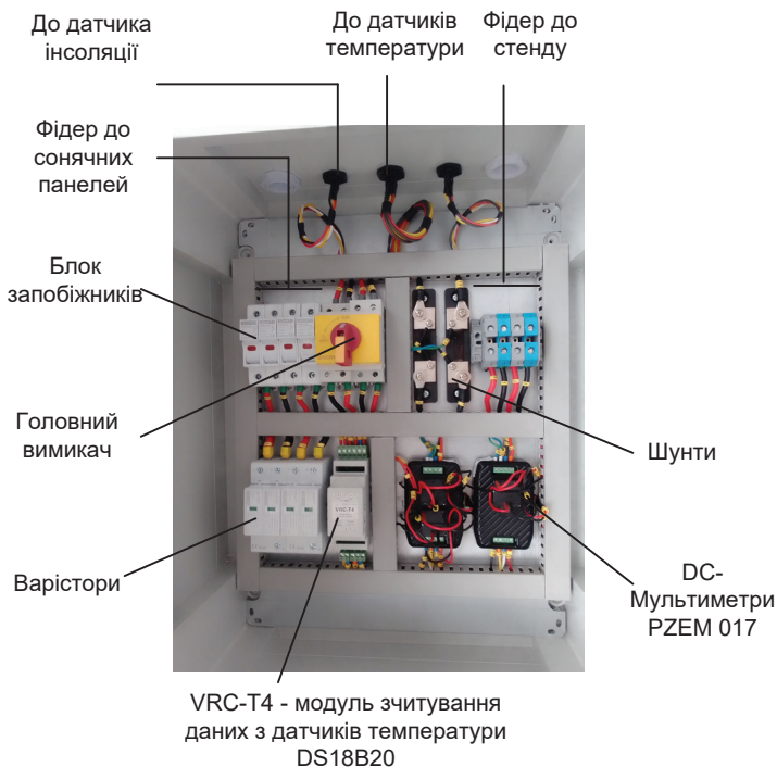
Рисунок 5 – Щит підключення фотоелектричних модулів (5-й поверх ННІАЕ)
