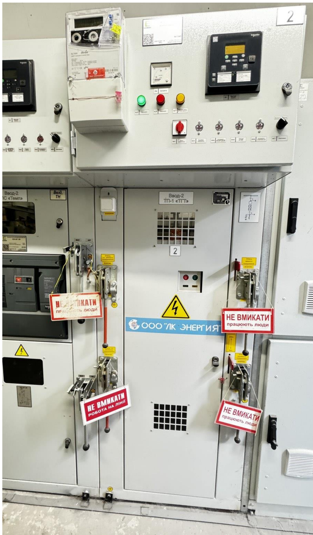
Рис. 4.11– Комірка №2, живлення трансформатора Т2
