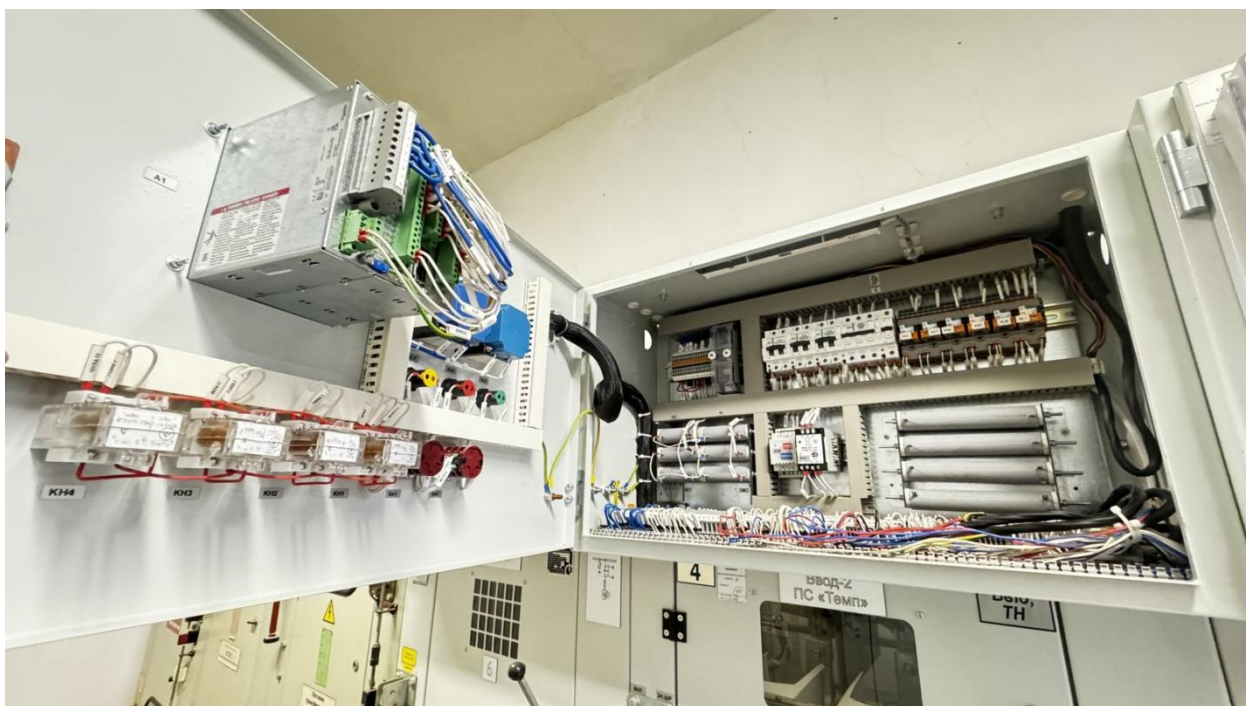
Рис. 4.10 – Релейна шафа кімнати №4
