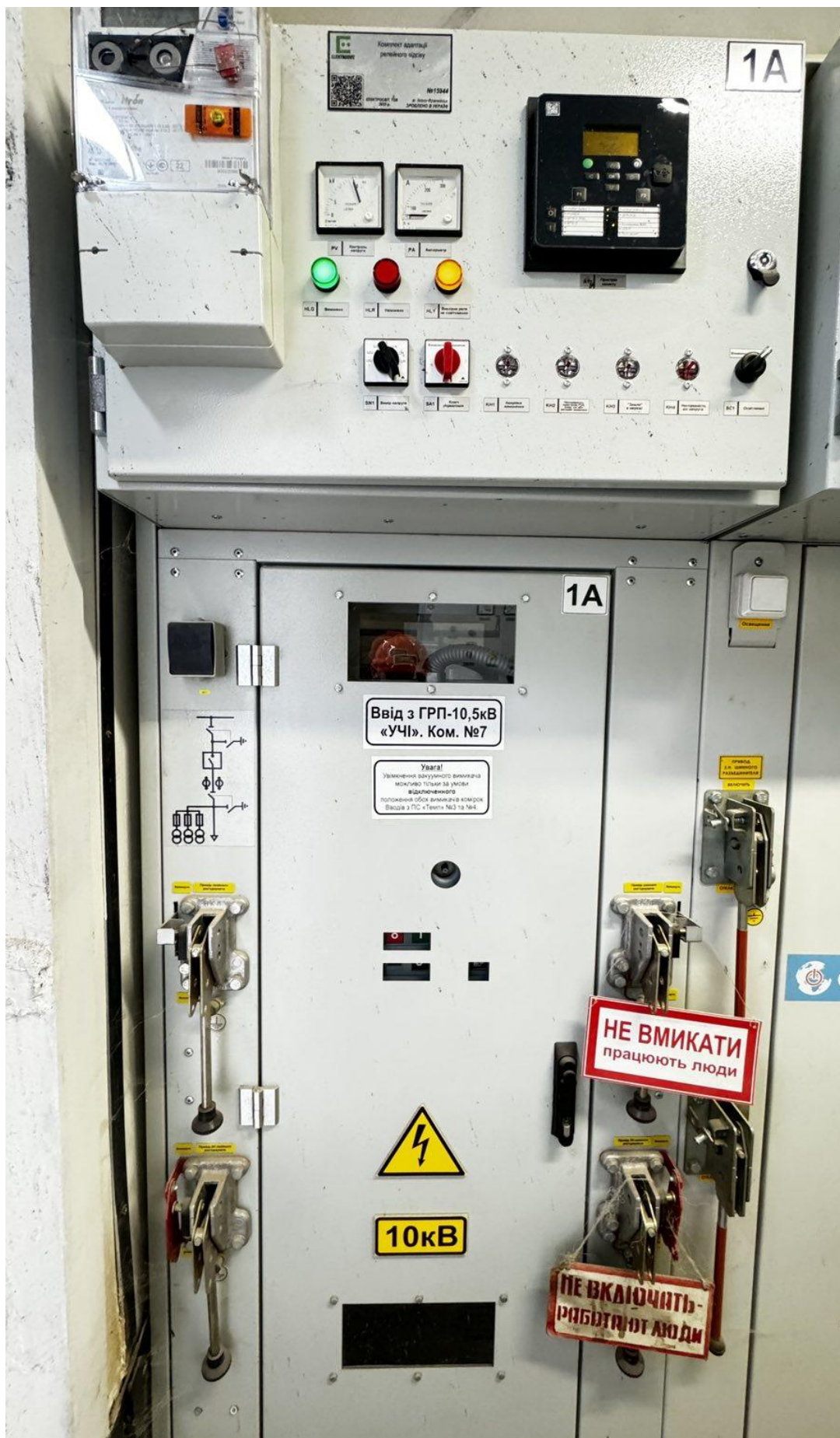
Рис. 4.4 – Комірка №1А, резервне живлення ТП
