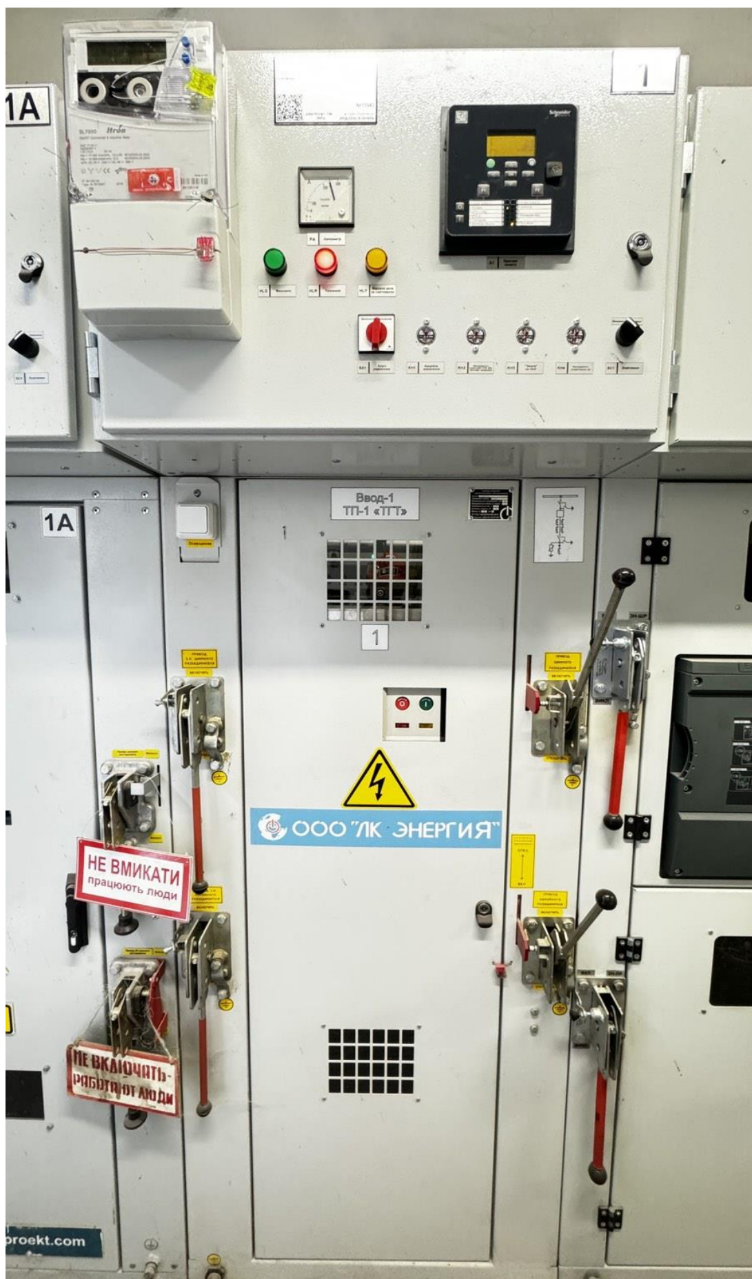
Рис. 4.6 – Комірка №1, живлення трансформатора Т1
