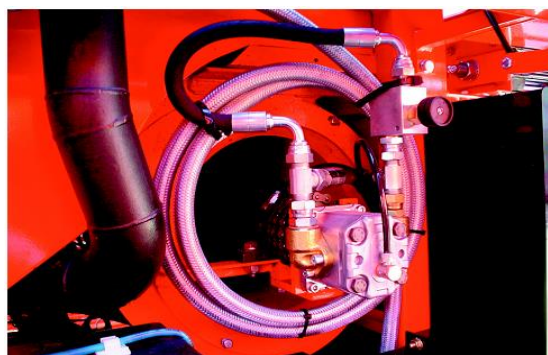
Рисунок 2 Гідромотор, який обертає вал вентилятора
