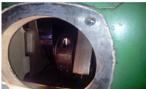
Рис. 3. Вигляд колінчатого валу газового двигуна Jenbacher 420 після поломки
